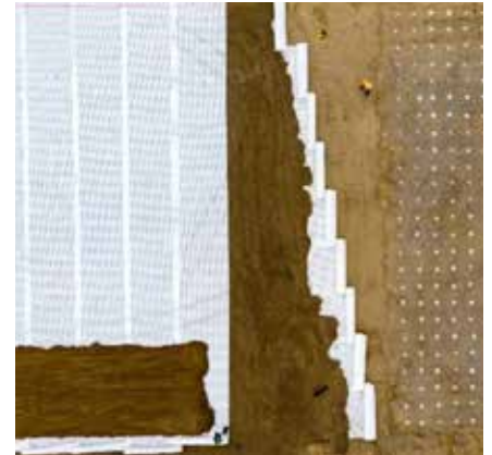
Bild 3: Zweilagige Geogitter-Verlegung innerhalb des vor Kopf über den CMC eingebauten Sandpolsters [10] (© menard)
